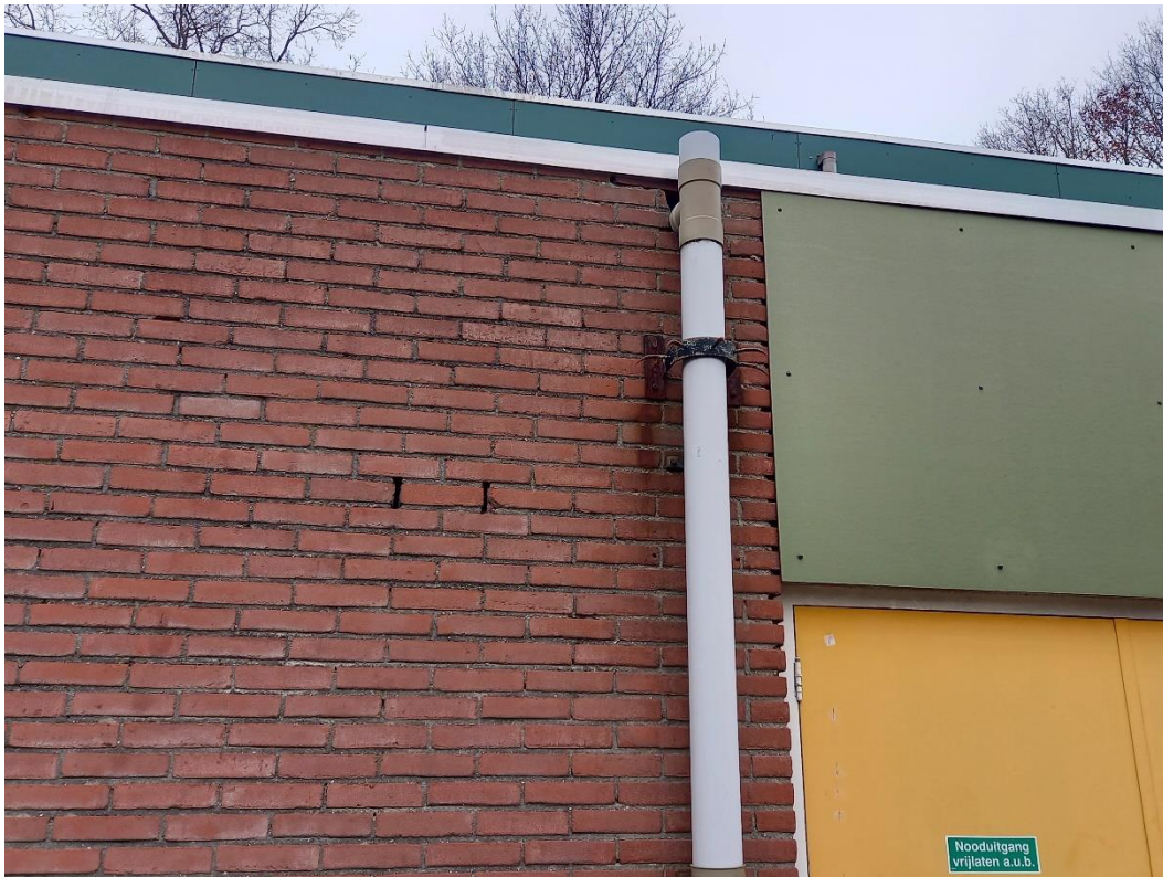
Figuur 8. Openingen in buitenmuur bieden toegang aan vleermuizen tot spouw- en dakruimtes.
